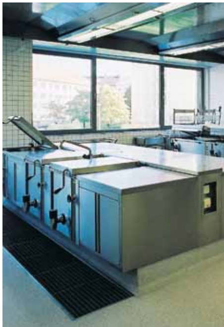
Großküche der Mensa der Universität Chemnitz
